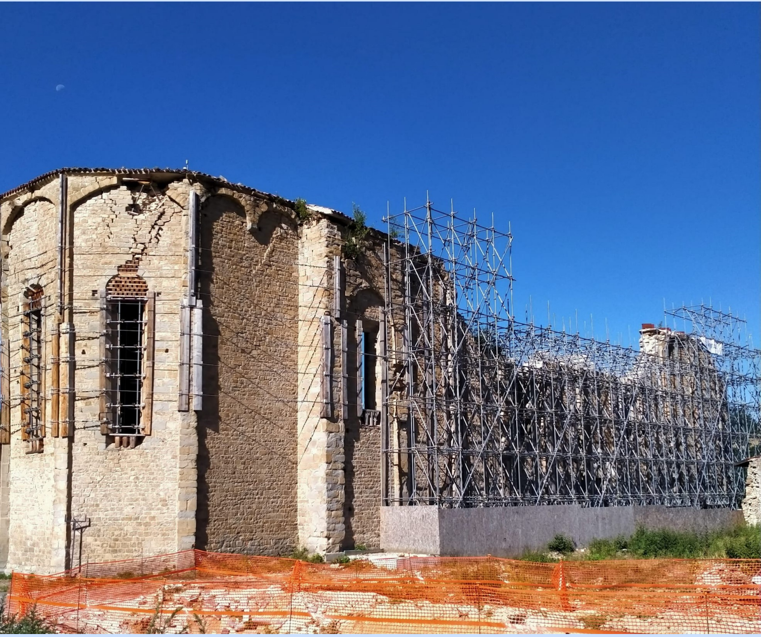
Esterno della chiesa del convento di S. Francesco ad Amatrice dopo il terremoto del 2016.
